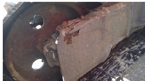
Observation 0202 : PRESENCE FORTE DE ROUILLE
