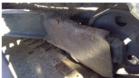
Observation 0202 : PRESENCE FORTE DE ROUILLE
