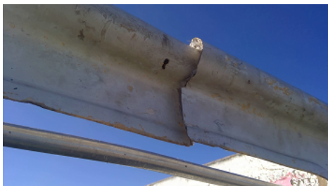
Observation 0801 : Détérioration du panier
