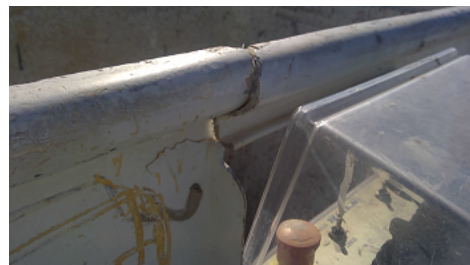
Observation 0801 : Détérioration du panier
