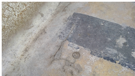
Observation 0801 : Détérioration du plancher
