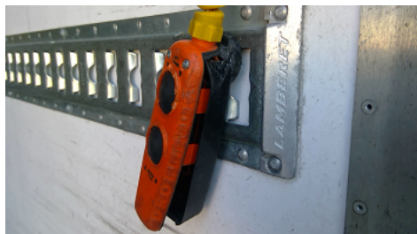
Observation 0701 : DETERIORATION DE LA COMMANDE FILAIRE
